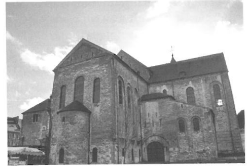
↓ Le chevet du chœur de la collégiale portant la trace d'une ferme de charpente d'une couverture de tuiles.
